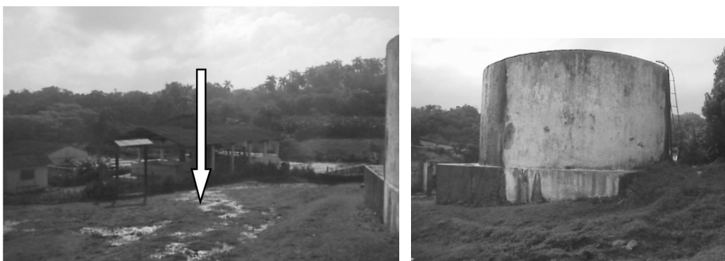
Fig. 2. Derecha: Depósito de agua del Centro de Beneficio de Café. Izquierda: derrame de agua.
